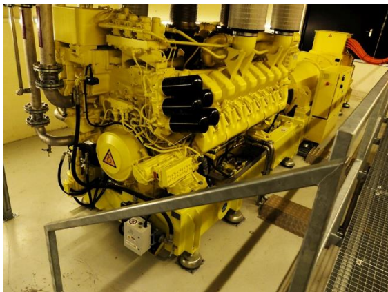
Notstromversorgung im CBT
